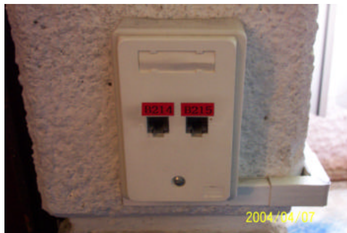
Figura 3.3 Muestra de una toma en RJ45 para equipo de cómputo
