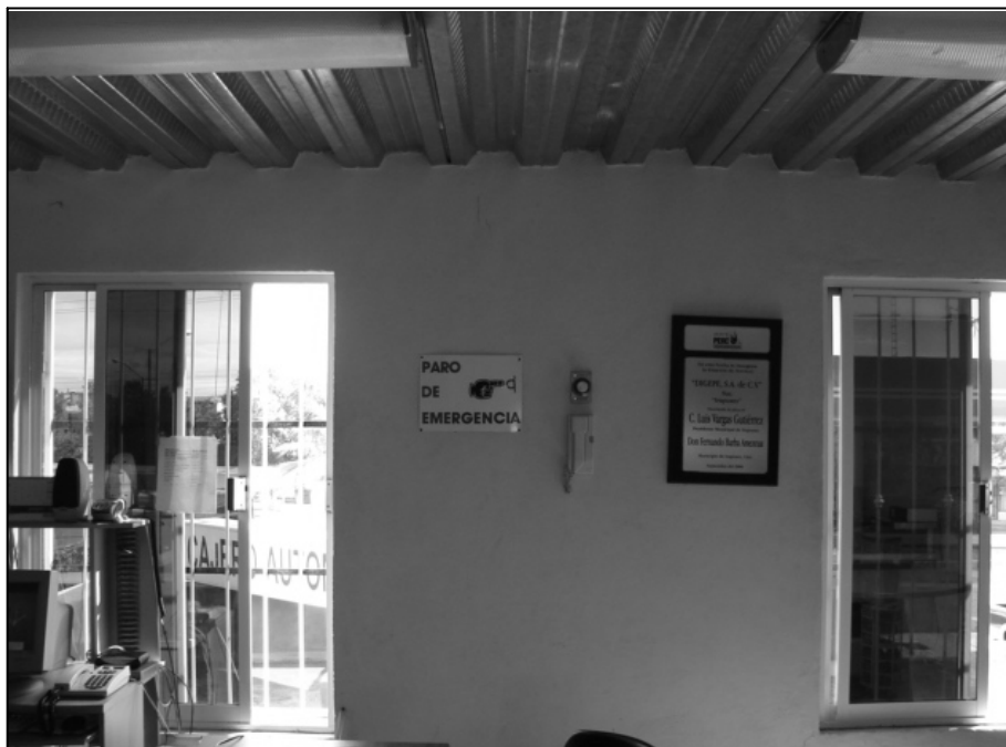
Figura 7.1.1 Botón de paro de emergencia y luminarios en la oficina
