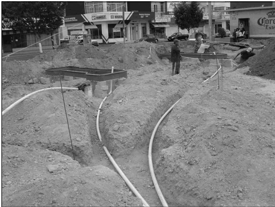
Figura 4.1.2 Instalación de tuberías de conducción de gasolina, recuperación de vapores, Instalación eléctrica, Instalación de aire y agua.
