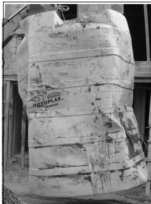
Figura 5.2.2 Esta cisterna se instaló sin hacer caso al llenado de agua antes de iniciar el relleno de la fosa
