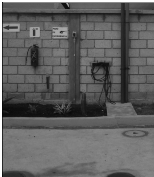
Figura 7.5.1 Paro de emergencia en zona de tanques
