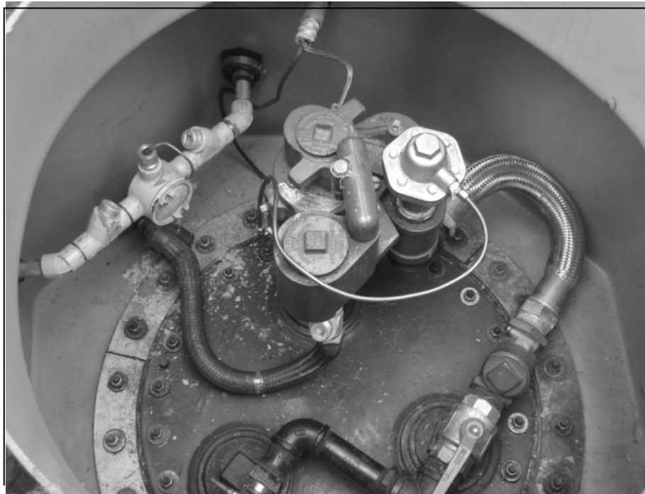
Figura 7.7.2 Bomba sumergible y conexiones
