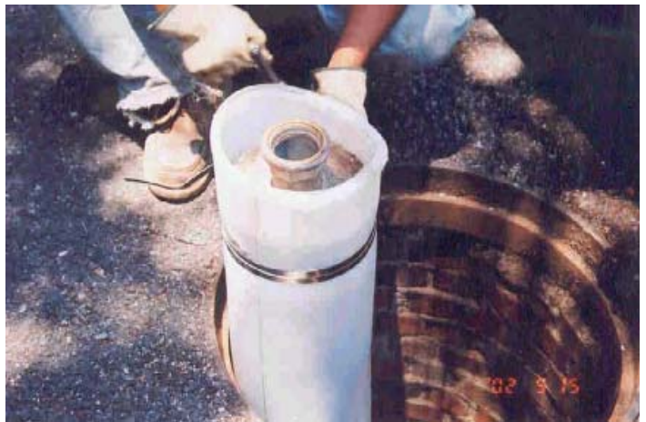
18.-Recibimiento de tubería colocada y preparación de mecanismo para inflado Fuente Industrias de Saneamiento y Desazolve, S.A. de C.V.
