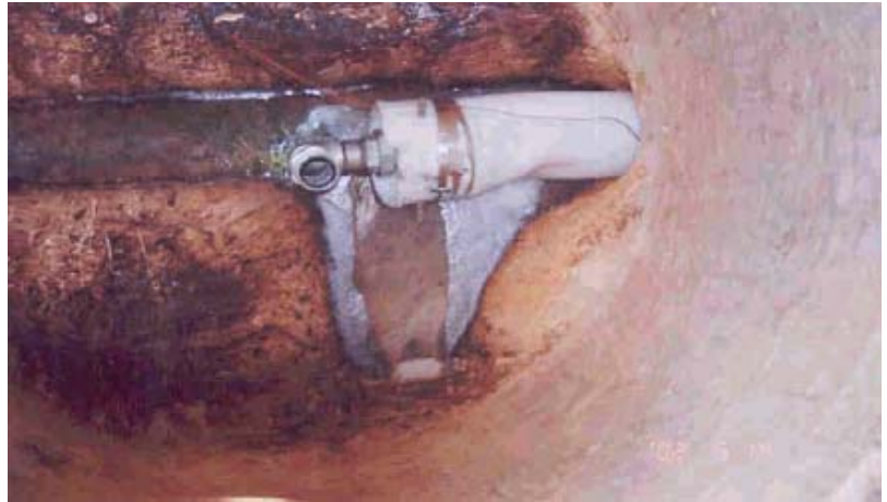
16.-Tubería colocada y preparación para recibir proceso de inflado. Fuente Industrias de Saneamiento y Desazolve, S.A. de C.V. Reproducción con fines académicos
