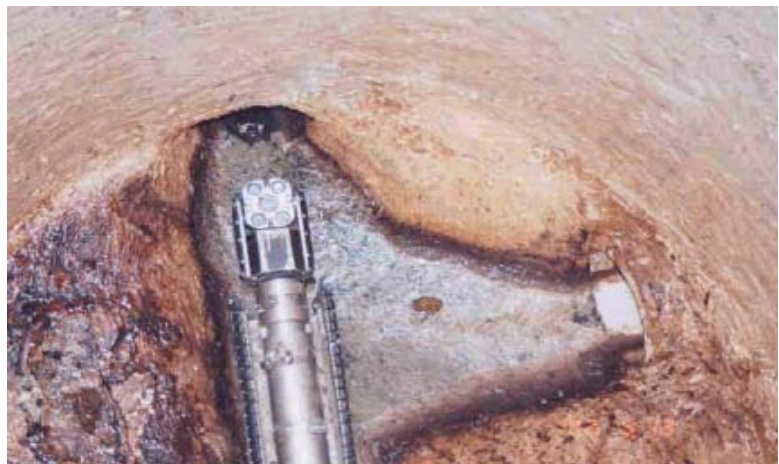
6.-Cámara para monitoreo en el interior de la red Fuente Industrias de Saneamiento y Desazolve, S.A. de C.V. Reproducción con fines académicos
