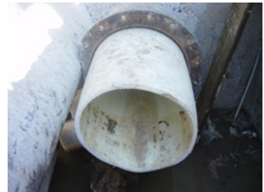
Tubería anfitriona con tubería en "U" de polietileno de alta densidad colocada
