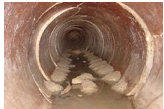
Fuente Industrias de Saneamiento y Desazolve, S.A. de C.V. Presencia materiales sólidos Reproducción con fines académicos
