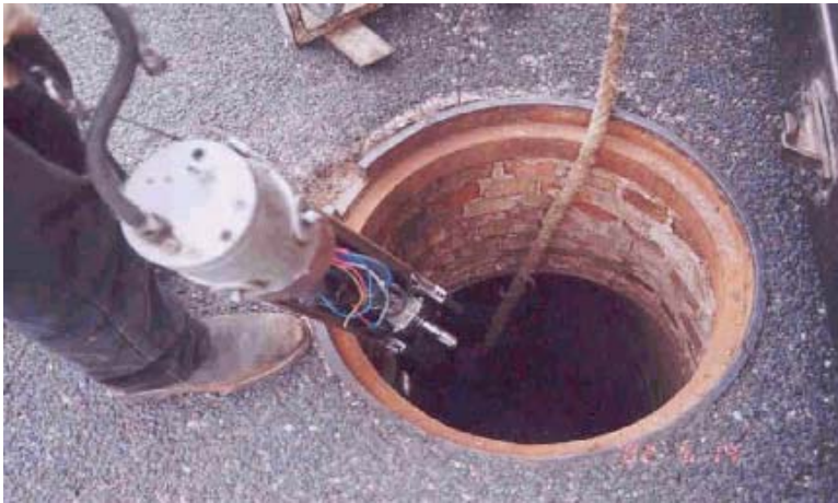
26.-Introducción de cámara para monitoreo de verificación del trabajo Fuente Industrias de Saneamiento y Desazolve, S.A. de C.V. Reproducción con fines académicos
