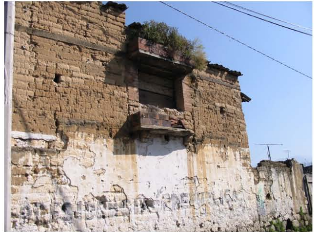
El deterioro en la vivienda tradicional es severo, en varias de las comunidades. Foto GTZ
