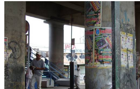
Fig. 19 Columnas del puente con grafitis que hacen parecer insegura esta zona.
