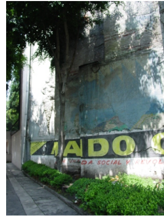
Foto 3. Relingo sobre Reforma.
