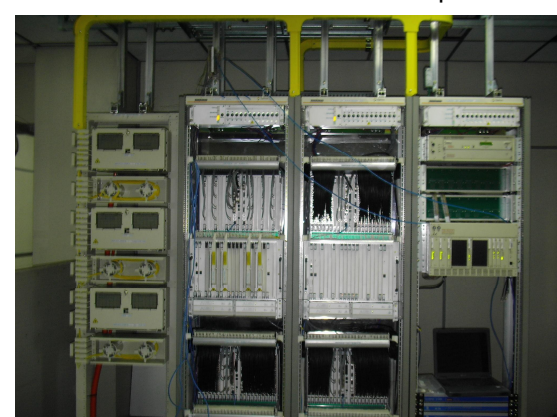
Equipos de Transmisión
