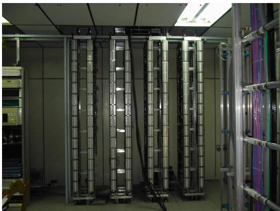
Equipos de Transmisión Multiplex
