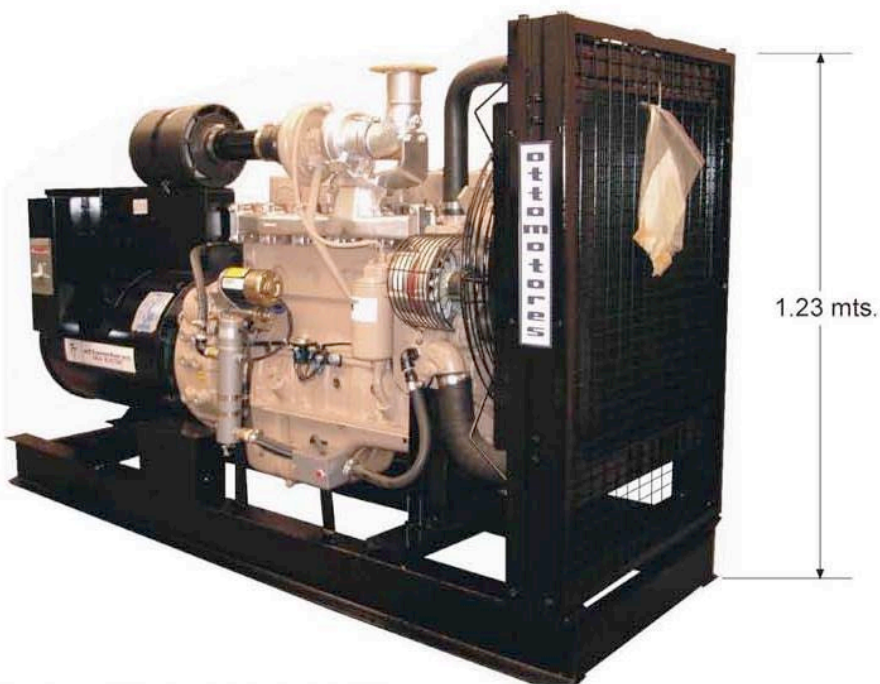
(Fig. 3.5.2.1) Planta de emergencia utilizada en las salas de juego.
