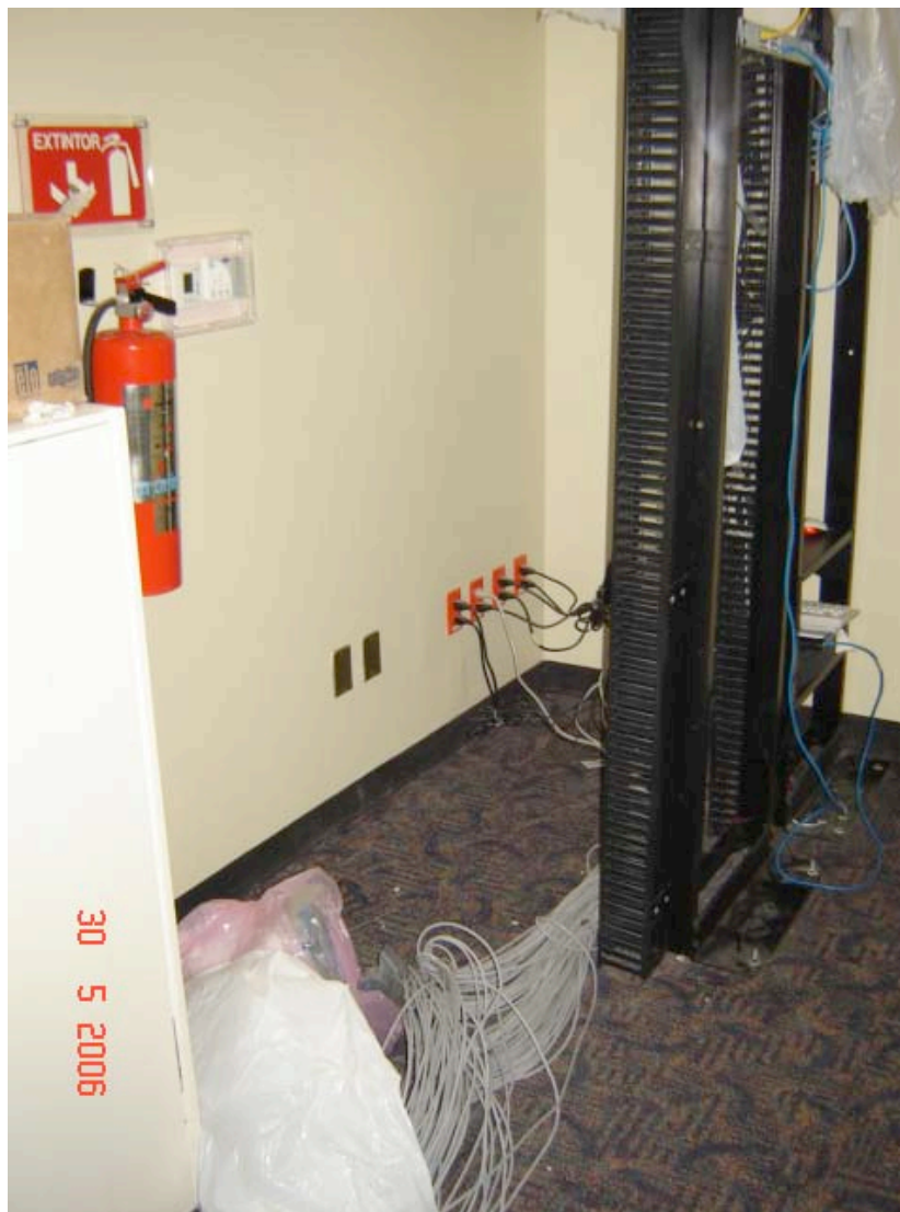
(Fig. 3.3.4)Cuarto de Telecomunicaciones listo para el montaje de equipos.
