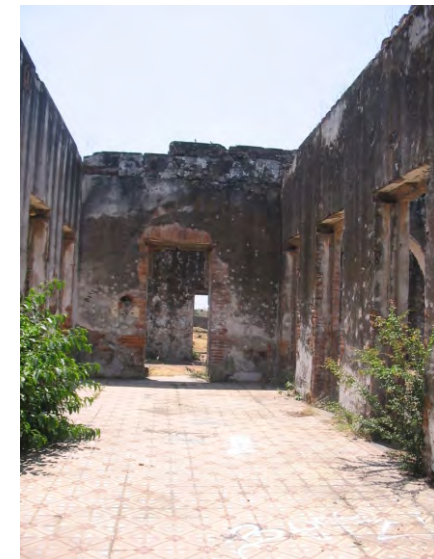
DESPRENDIMIENTO DE APLANADOS
