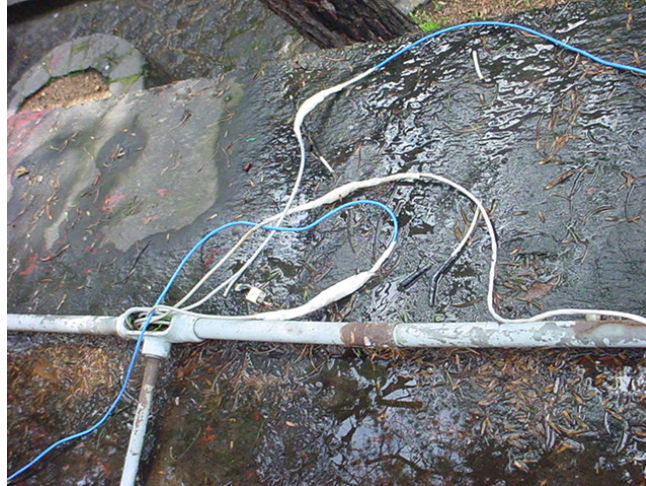
Figura 3.1 Cable mal instalado
