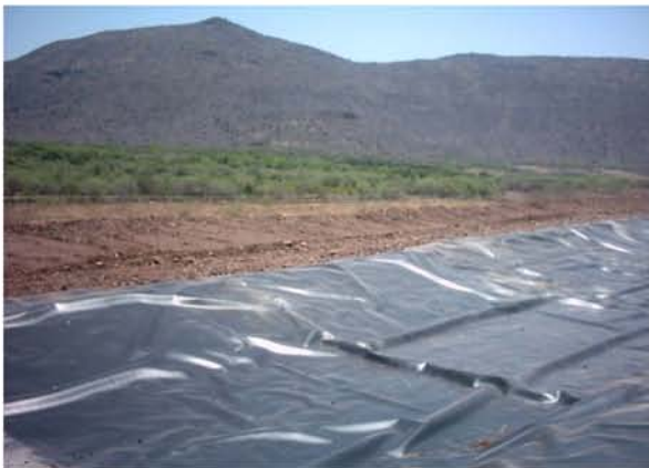
Preparación de la segunda celda en prevención del llenado de la primera celda calculada en proyecto para una capacidad del 3% de la generación diaria de 12.66 ton/día o sea menos 0.5 ton/día la realidad cambio este volumen.
