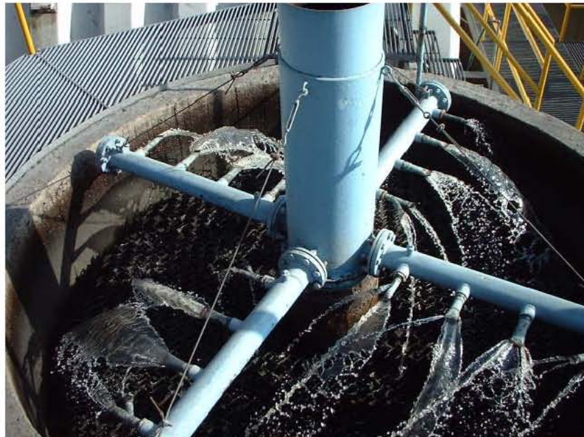
Fig. 7 Sistema de rocío del filtro percolador.
