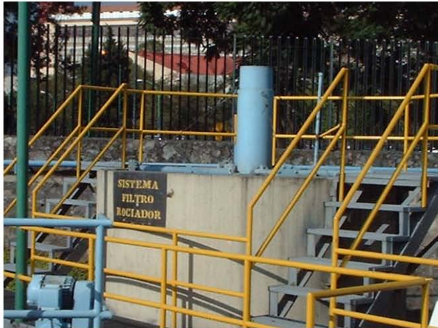
Fig. 6 Sistema de filtro rociador (percolador) de la PTARCU.
