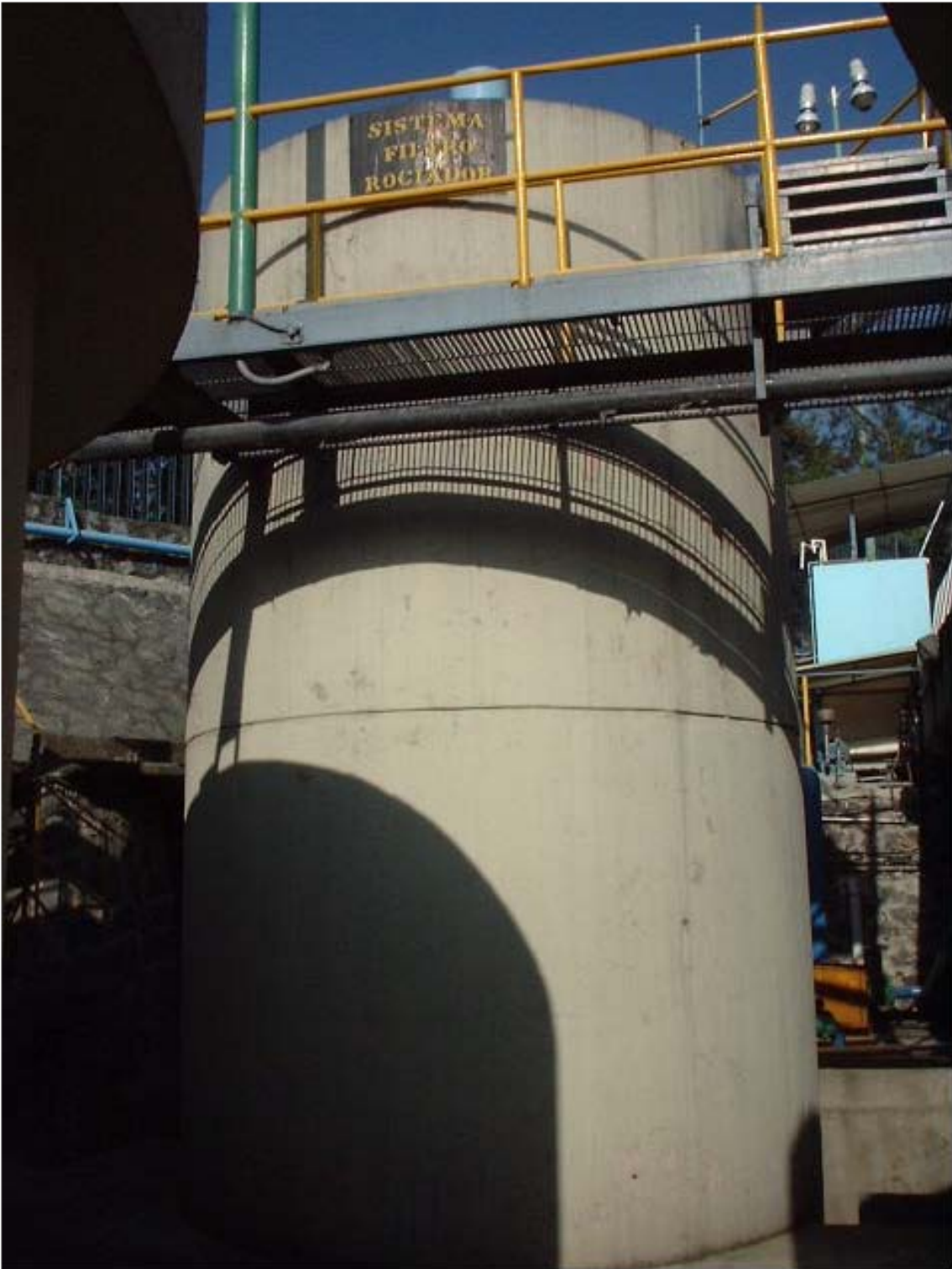
Fig. 8 Torre percoladora del Filtro Rociador.
