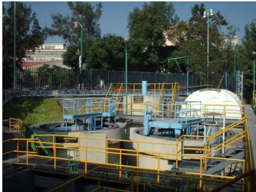
Fig. 3 Sistemas de tratamiento de la PTARCU, num 1
