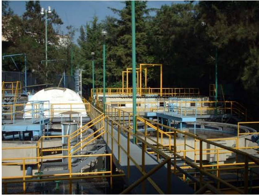
Fig. 4 Sistemas de tratamiento de la PTARCU, num 2
