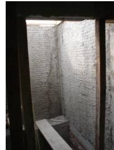
Aplanado del panel mediante mezcla cemento – arena hasta ocultar el armado. Listo para recibir yeso.
