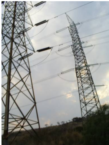
Torres de Energía Eléctrica (Por las cuales se abastece al terreno)
