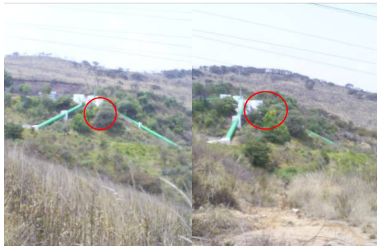
Caja Rompedora (Distribución de agua a Atizapan)
