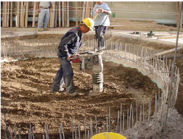
Figura C.2 Relleno y compactación al 90% de la prueba Proctor estándar en base de filtro percolador.
