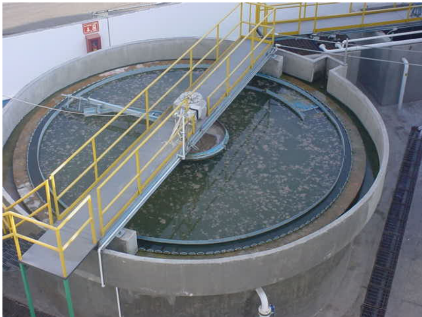
Figura C.18 Filtro Sedimentador en funcionamiento.
