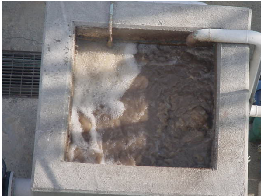
Figura C.17 Tanque de Bombeo en funcionamiento.
