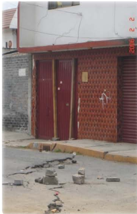
Figura 19. Afectaciones a la infraestructura civil en la calle Océano esquina Piraña
