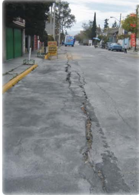
Figura 17. Las grietas pueden presentar aperturas mayores a 10 cm. El daño a la cobertura asfáltica afecta a los transeúntes.
