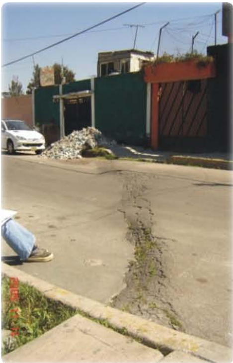
Figura 18 Desarrollo de grieta a lo largo de la calle Abulón esquina La Turba.
