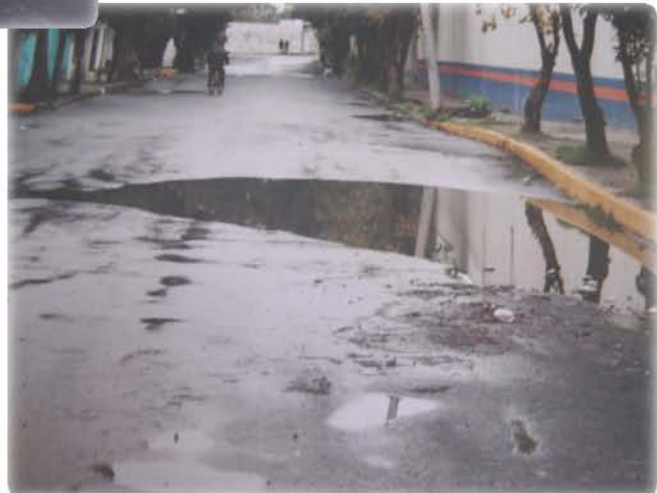
Figura 12. Los daños a la infraestructura civil se reflejan principalmente en pavimento, banquetas y postes de luz.
