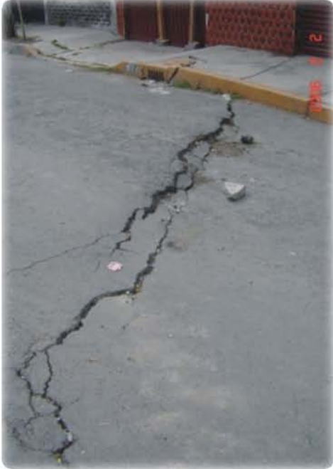
Figura 16. El arreglo en echelón se presenta en forma de escalones, el desarrollo de la grieta puede ocupar los espacios en la zona de relevos.
