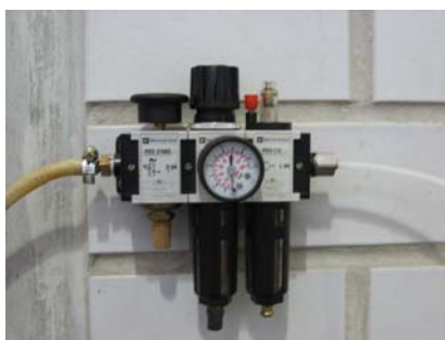
Fig. 2.6 Regulador de presión utilizado en el arreglo final
