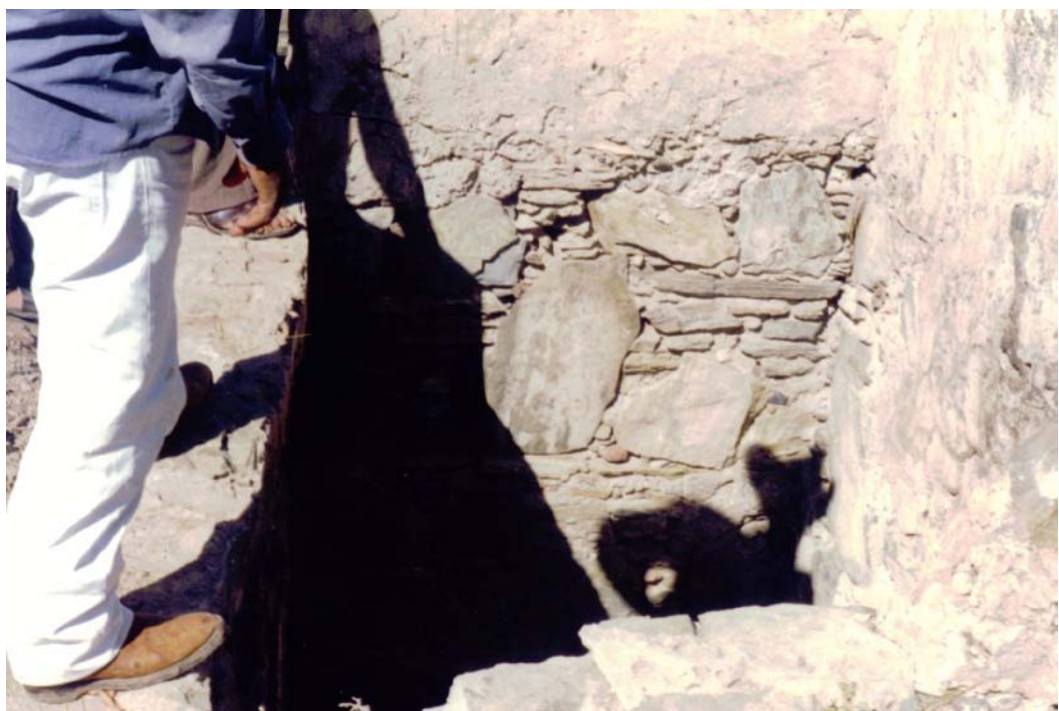
El brocal de La Noria derrocada
