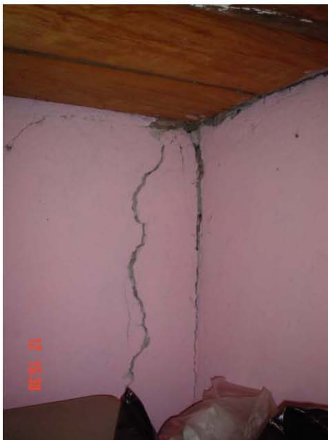
Figura 6 Daños estructurales en vivienda
