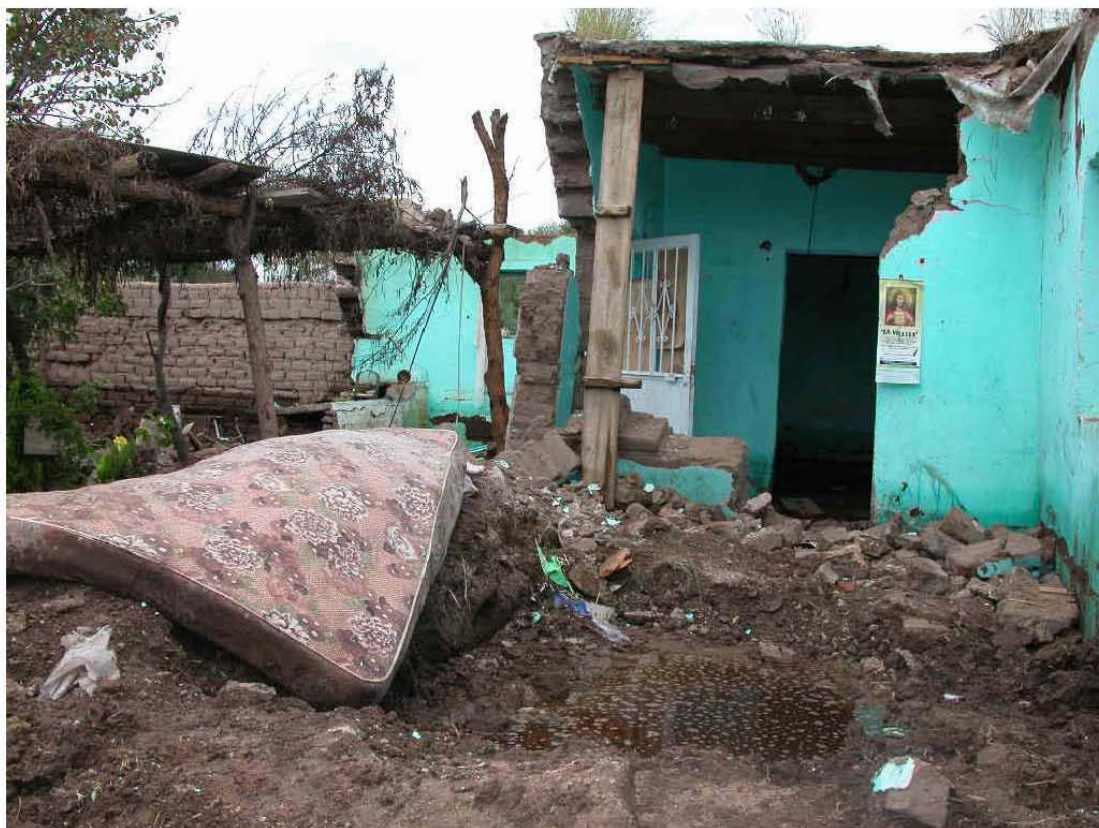
Figura 5 Vivienda afectada en el municipio de Poanas.
