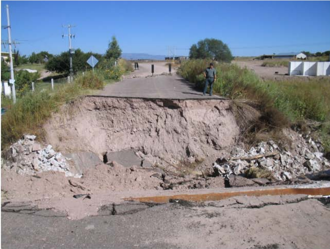
Figura 10 Colapso de puente de 15 metros de claro
