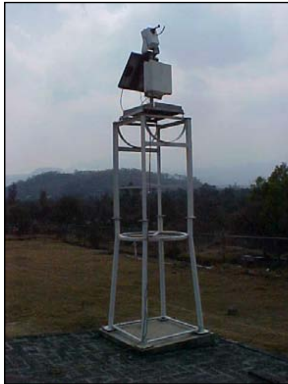
Figura 4.9. Instalación de la estación meteorológica en la Planta Solar.
