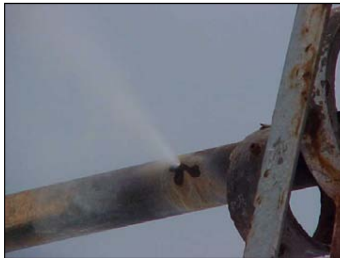
Figura 5.2. Fuga en un absorbedor.
