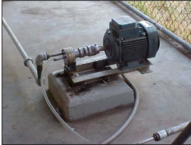
Figura 3.49. Primera bomba de suministro.
