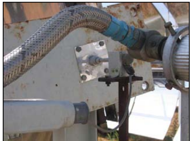
Figura 4.32. Montaje en el módulo de concentradores
