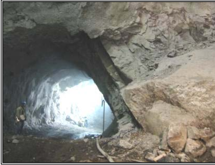
Parte más baja del tímpano norte de casa de máquinas donde se aprecia el dique-falla donde presentó condiciones inestables
