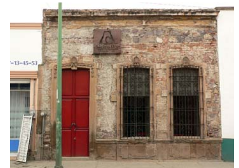
Imagen 192. — Ejemplo de muro fabricado en tabique recocado rematado por una cadena de arrastre y pretil con calicanto. Calle 5 de Febrero #315.
