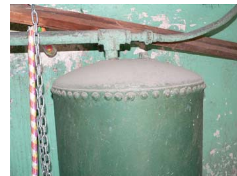
Imagen 225.- Vista actual del tanque para calentar agua en planta baja, para subirla al tanque del quinto nivel.
