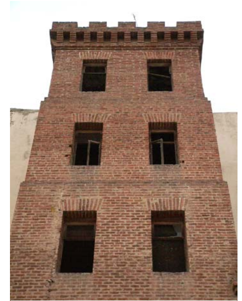
Imagen 257.- Vista de los tres últimos niveles de la torre abandonados
