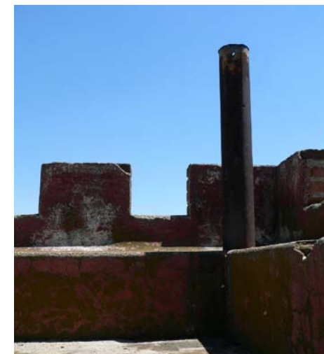
Imagen 224.- Vista actual del tubo como tiro de chimenea en azotea para sacar los humos de la fragua del cuarto nivel.
