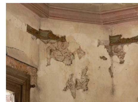
Imagen 231.- Detalle del acabado interior original en la actualidad, donde se puede observar el papel tapiz y la moldura superior.
