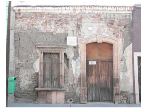
Imagen 191. — Ejemplo de muro fabricado en adobe y reparado en su parte superior con tabique recocado. Calle Justo Sierra #431.
