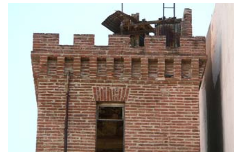
Imagen 251.- Remate de la torre de tabique, donde se observan grietas.
