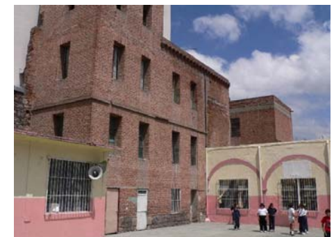
Imagen 261.- Vista del segundo patio que se propone aprovechar para ubicar una cafetería y el espacio de recreación.
