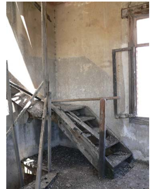
Imagen 258.- Vista interior de los niveles abandonados y del estado de deterioro irreversible de la carpintería.
