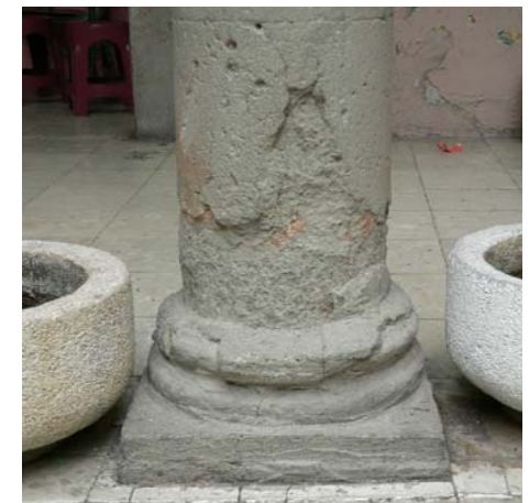
Imagen 256.- Daños en cantería por falta de mantenimiento y mal uso.
