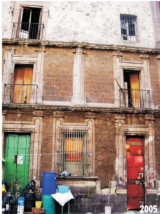
Alteraciones en la fachada principal (21)
