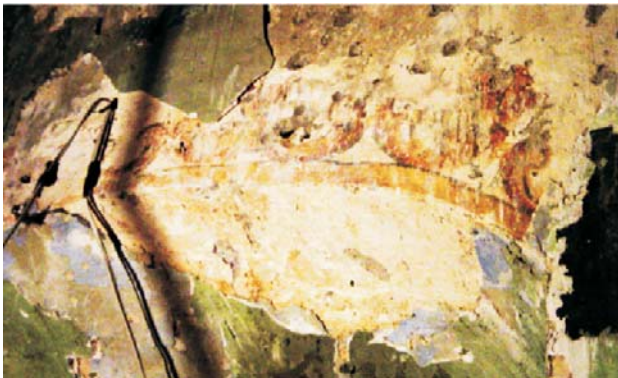
Detalle de los restos de la pintura a la cal de la casa # 5 (15)
