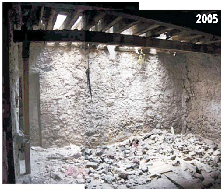
Perdida de rellenos y sobrecarga al piso inferior 14
