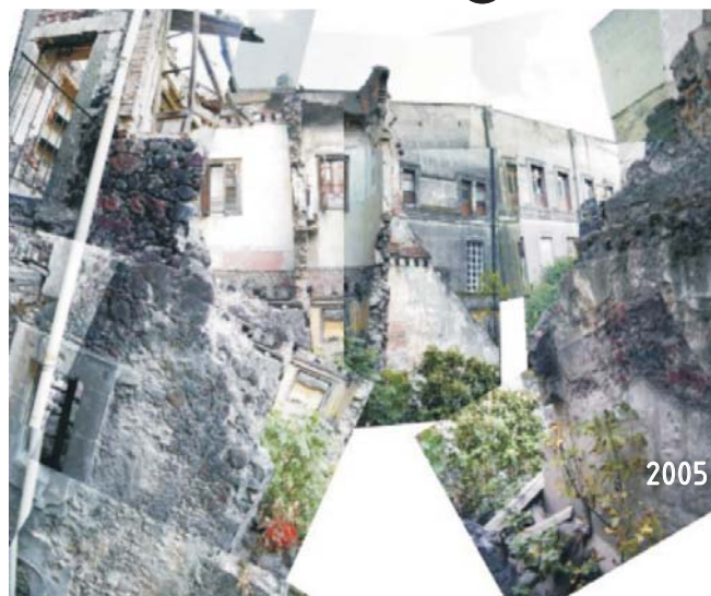
3RA. ETAPA. OQUEDAD Y PERDIDA TOTAL DE CUBIERTAS EN ÁNGULO SUR PRESENCIA DE AGREGADOS DIVERSOS LATERALES. ④
