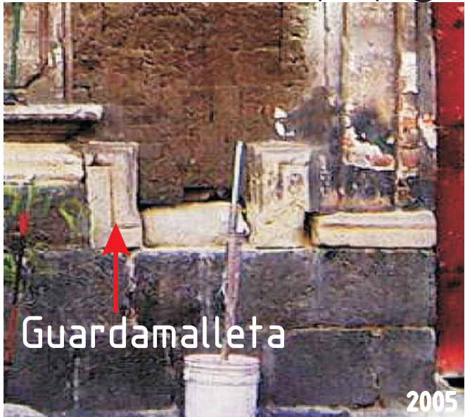
Desgaste y pérdidas parciales de piezas de cantería (22)
