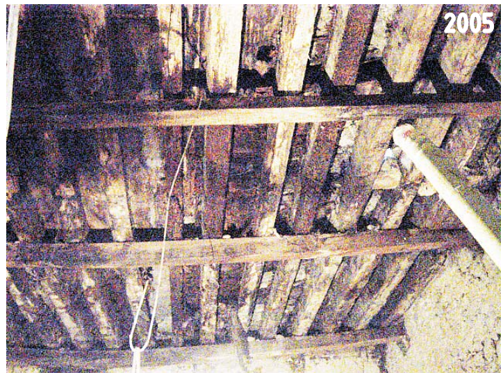
Perdida y debilitamiento de la vigería además de sobrecarga 15
