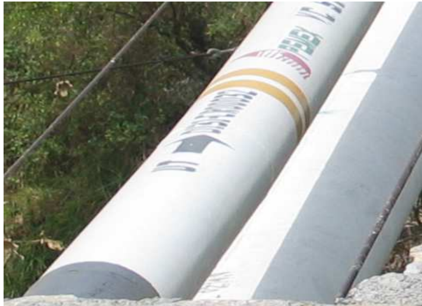
Figura 16.- Ducto de PEMEX en el DDV.
