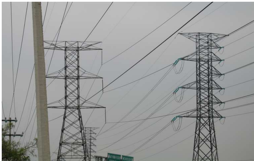
Figura 18.- Tipos de torres de transmisión eléctrica en el DDV bajo estudio.
