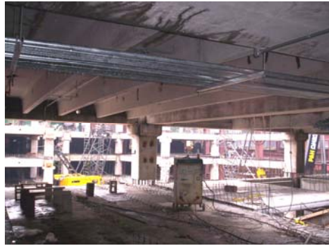
Fig. 2.1.76- Pasos de instalaciones
