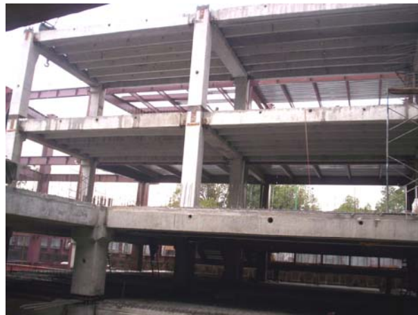
Fig. 2.1.77- Pasos de instalaciones
