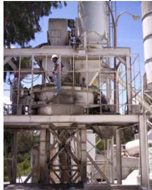
Fig. 1.11.8- Dosificadora de concreto
