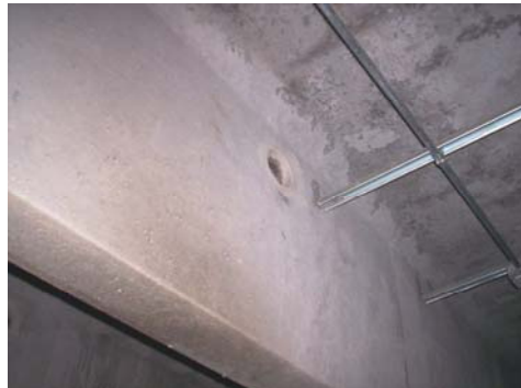
Fig. 2.1.74- Pasos de instalaciones
