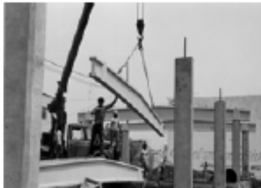
Fig. 1.2.9- Montaje de traveses "I" de sección variable para las aulas del sistema CAFCE
