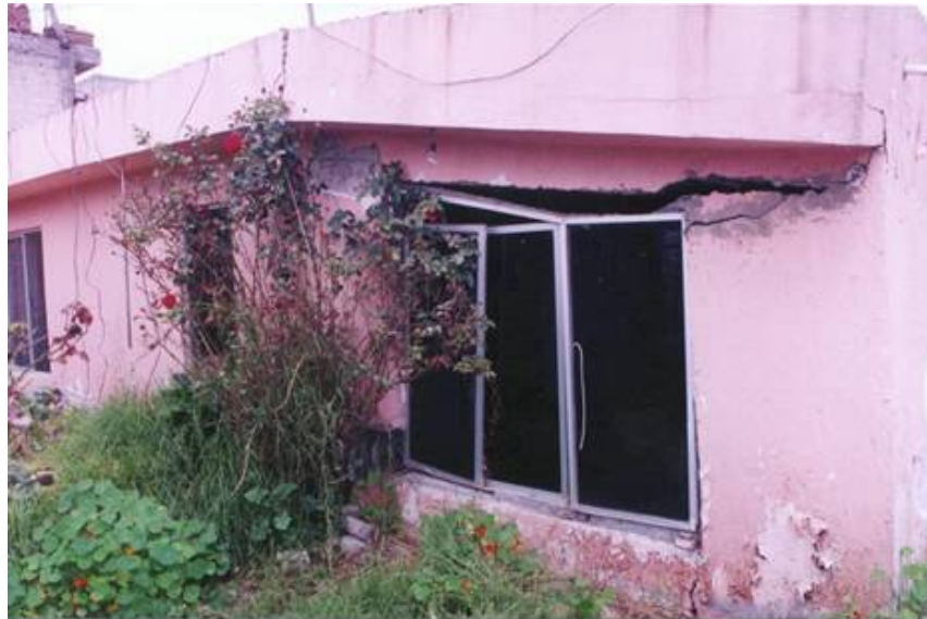
Figura 3.4. Afectaciones de los hundimientos diferenciales sobre una vivienda
