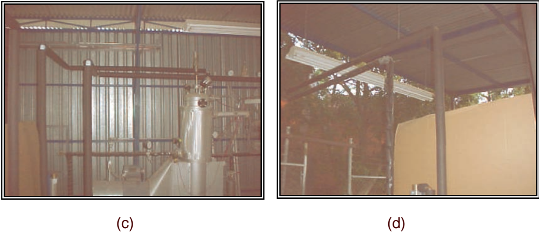
Figura 5.2.4 (a) y (b) Aplicación del aislamiento a los intercambiadores de calor, (c) y (d) colocación del aislamiento en las tuberías del sistema
