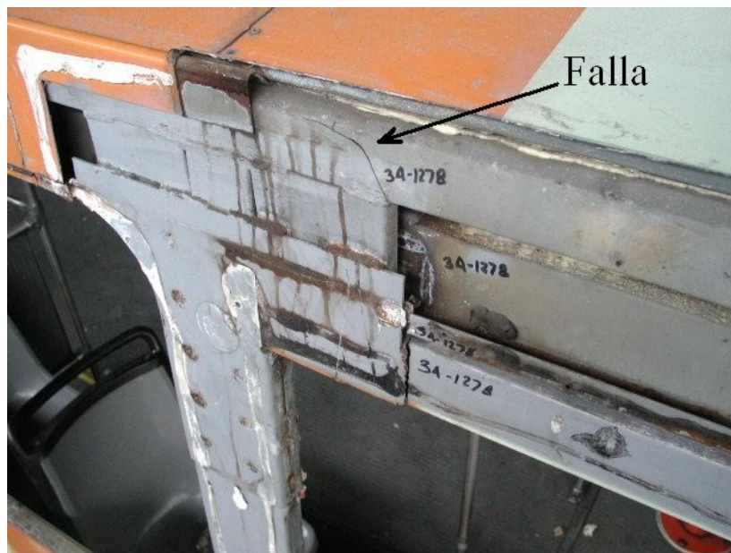
Figura 2-1. Falla en la estructura del autobús
