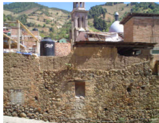
muro mixto de piedra de la región y ladrillo de barro rojo recocido asentado con agualodo, acabado aparente
