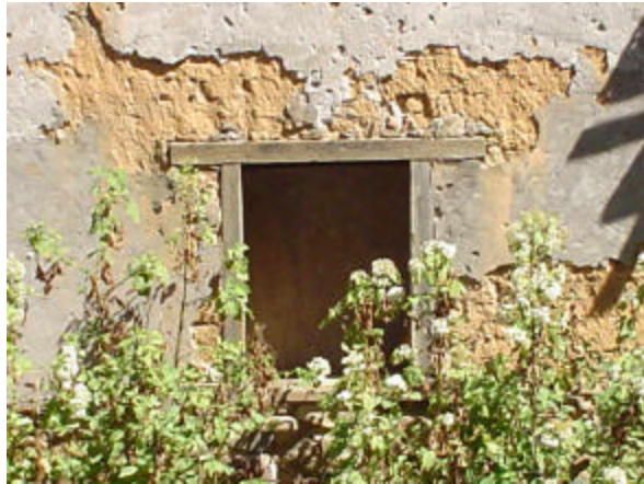
marco sencillo de madera ( pérdida de ventana ) tablereado de madera
