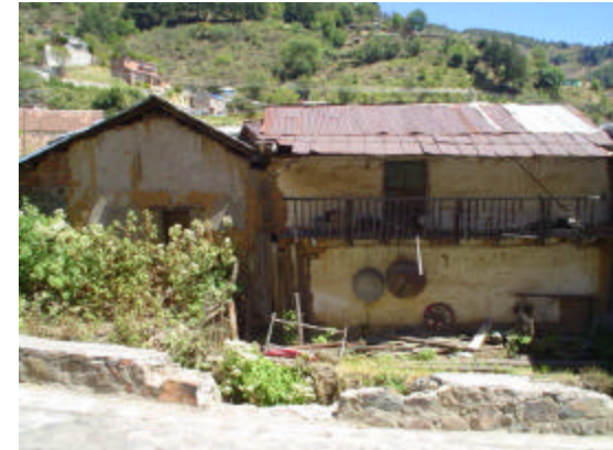
cubierta de lámina de zinc, sobre armadura de madera a base de morillos y cintas.
