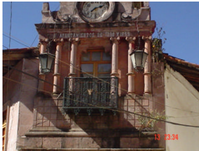
ventana balcón de herrería artística remachada con cerramiento mixtilíneo de cantera (presidencia municipal)
