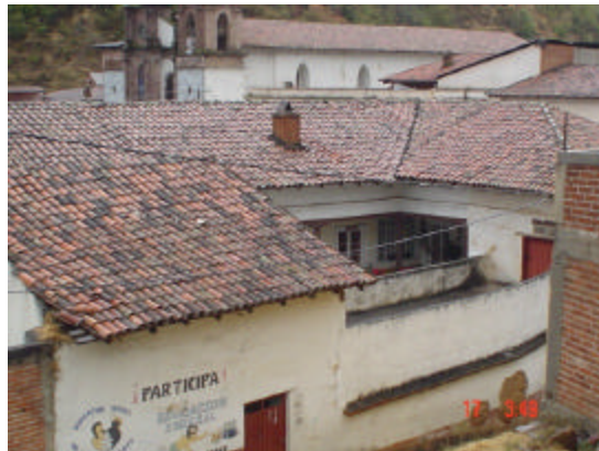
cubierta de teja de barro rojo recocido sobre armadura de madera a base de morillos y cintas
