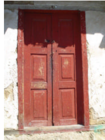
puerta de madera moldurada con marco sencillo de madera pintado con vinílica
