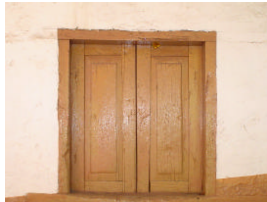
ventana de madera sencilla con marco sencillo de madera pintados con vinílica
