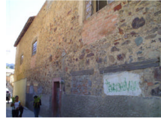
muro mixto de piedra de la región y adobe con tabique rojo recocido de 7x 14x 28 cm. a la mitad.
