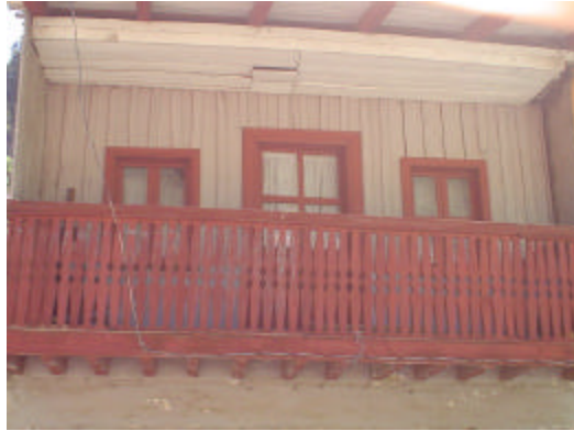
balcón corrido de madera, con balastras de corte neoclásico, acabado con pintura vinílica
