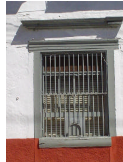
ventana de madera con barrotes de hierro de protección ( casa del correo del pueblo )
