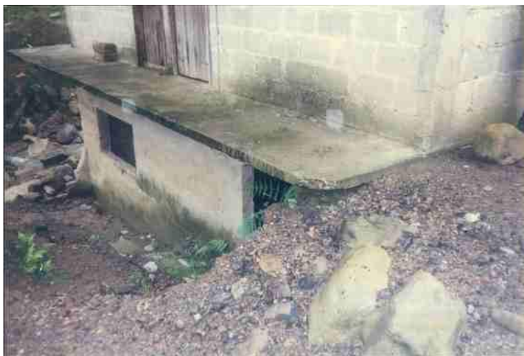
Figura 2.10. Daños en vivienda ocasionados por la ocurrencia de un proceso de remoción en masa en el municipio de Zapotitlán de Méndez. Fotografía de López Mendoza.
