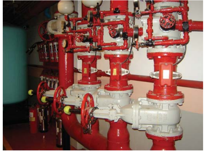
BOMBAS CONTRA INCENDIO
