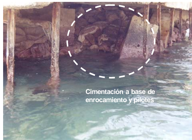
Figura. 3.6.- Socavación bajo el muelle existente
