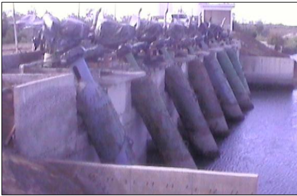
Figura. 1.4 Estación de Bombeo
