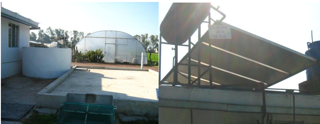
FIG. 30. Izquierda captación de agua de lluvia; derecha calentador solar.
