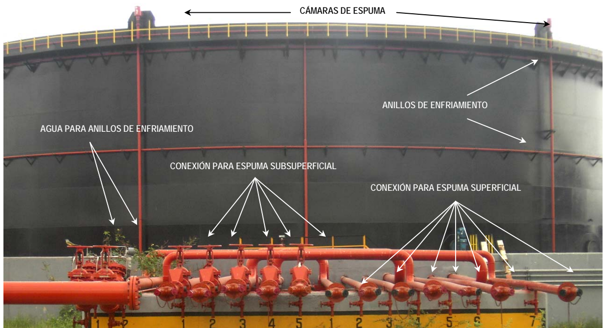
Figura 2.17.- Protección Contraincendio de un Tanque de Almacenamiento de Crudo de 200 000 bbl
