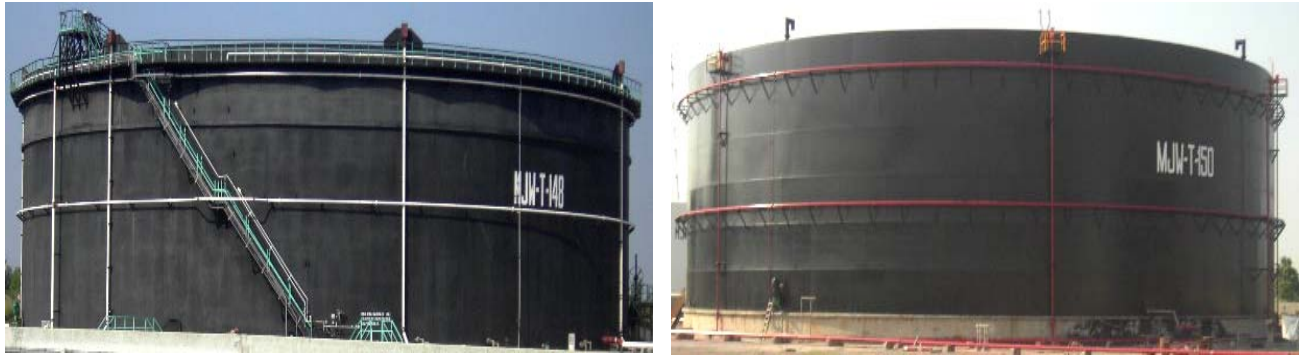
Figura 2.26. Tanques de Almacenamiento que Requieren Color Absorbente de la Radiación Solar
