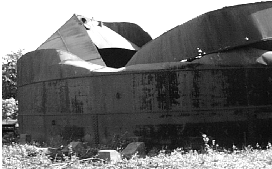
Figura 2.23.- Efectos de la Corrosión en Tanques de Almacenamiento sin Protección [18]
