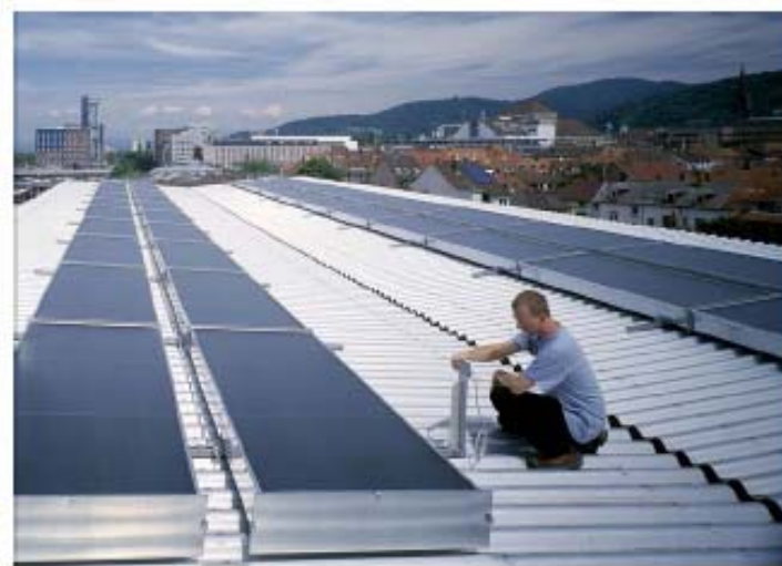
Figura 3.5 Sistema colector solar de aire instalado en la Cámara de Comercio en Freiburg Alemania.
