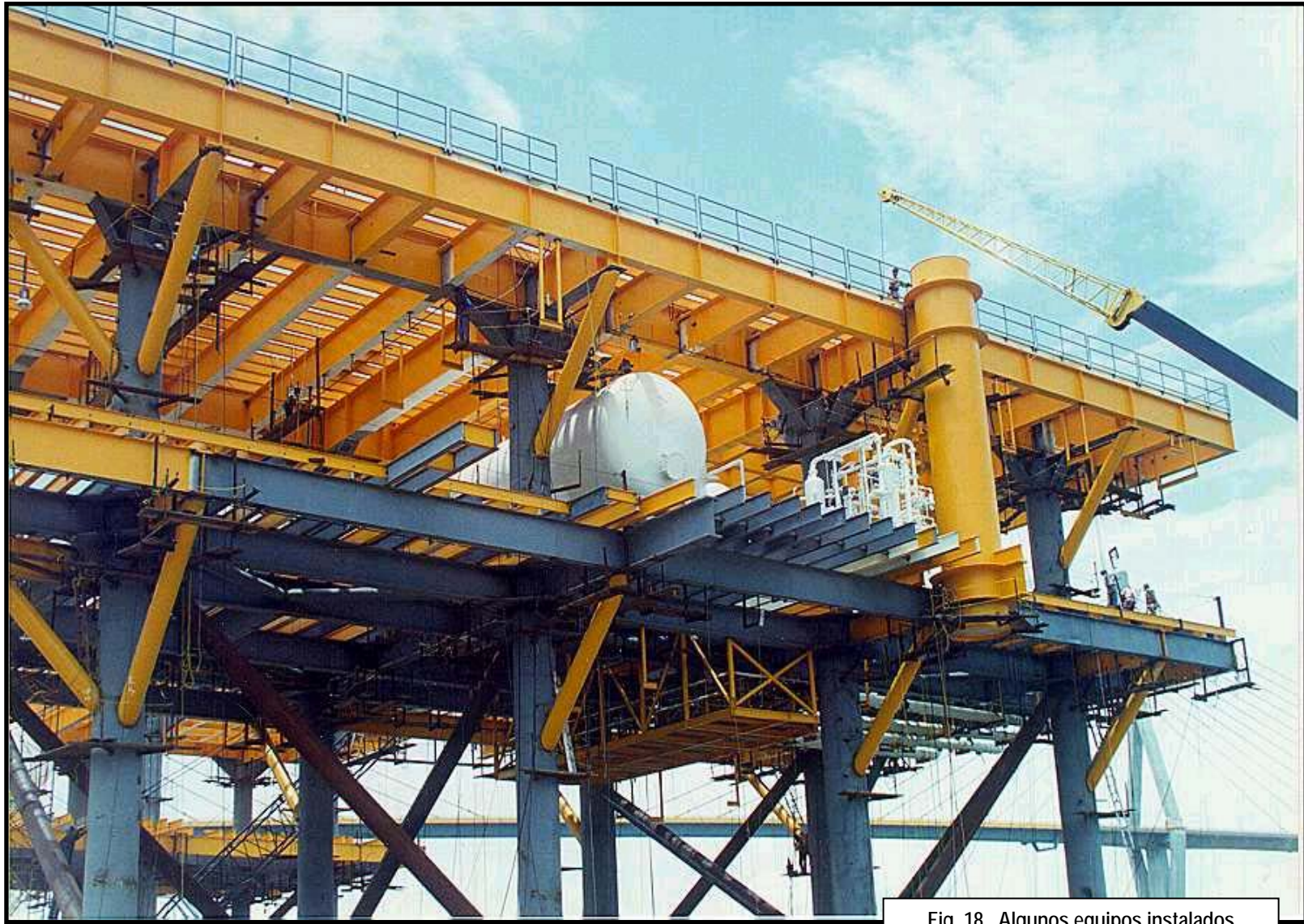
Fig. 18 Algunos equipos instalados
