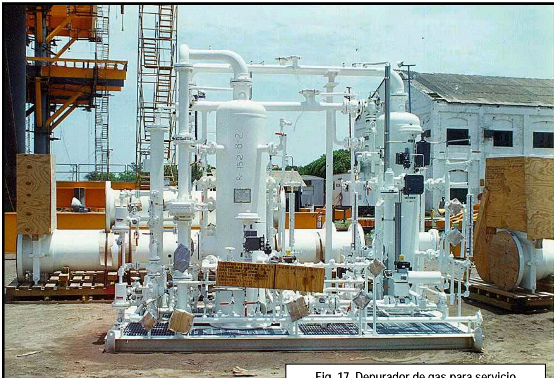
Fig. 17 Depurador de gas para servicio
