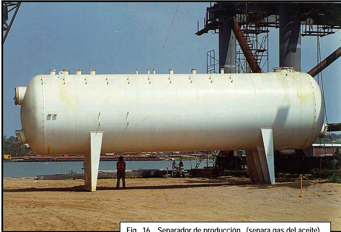
Fig. 16. Separador de producción (separa gas del aceite)
