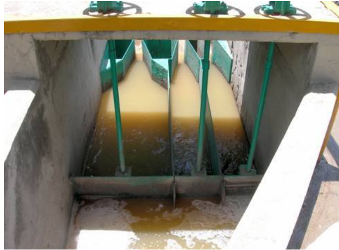
Figura 32. Salida del desarenador.
