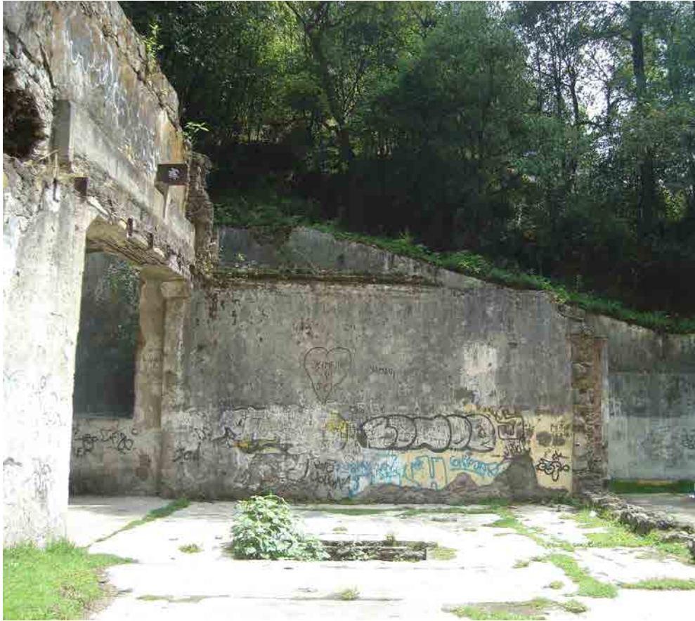
9. –Condición en la que se encuentran las ruinas que se localizan en el 3er Dinamo. (Parte frontal).
