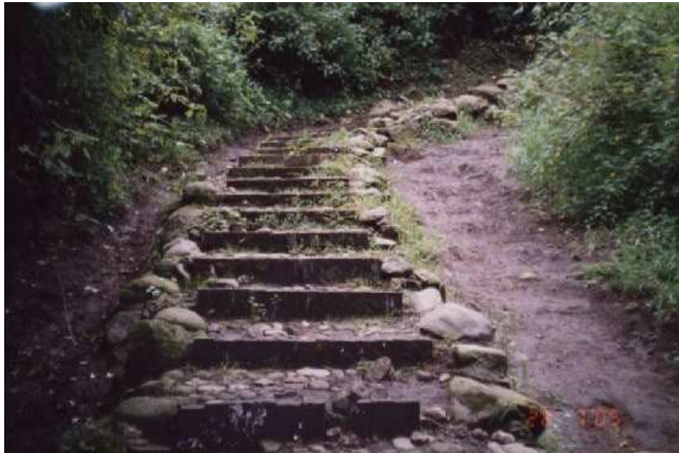
7. –Arreglo realizado al camino de terracería que corre del Dinamo 2 al Dinamo 1
