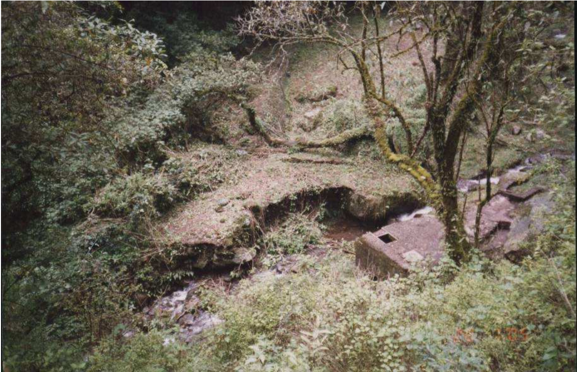
19. –Vista del Río Magdalena donde se muestra el deslave por el grado de erosión, localizado entre el Dinamo 4 y 3.
