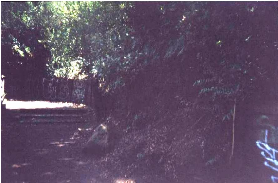
16. –Arreglos que se realizaron sobre el sendero a la altura del Dinamo 1, donde se puede ver sobre las paredes que contrarrestan la erosión indicios de vandalismo y la falta de tabloncitos en la parte central de la imagen los cuales se presume fueron arrancados.
