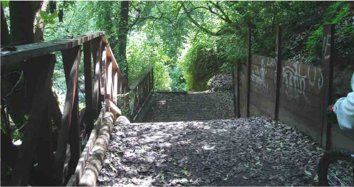
17. –Se puede apreciar una de las bardas para la retención de la erosión en pésimas condiciones, a lado derecho de la imagen; en el transcurso del 2º Dinamo al 1er Dinamo.
