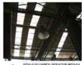
DETALLE DE CUBIERTA, ESTRUCTURA METALICA DE COLUMNAS DE ACERO INTERIORES DEL MERCADO
