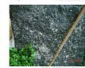
DETALLE DE COLUMNA DE CONCRETO DE PASADIZO DE PASAJES INTERIORES DEL MERCADO
