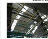
DETALLE DE COLUMNA DE CONCRETO DE PASADIZO DE PASAJES INTERIORES DEL MERCADO
