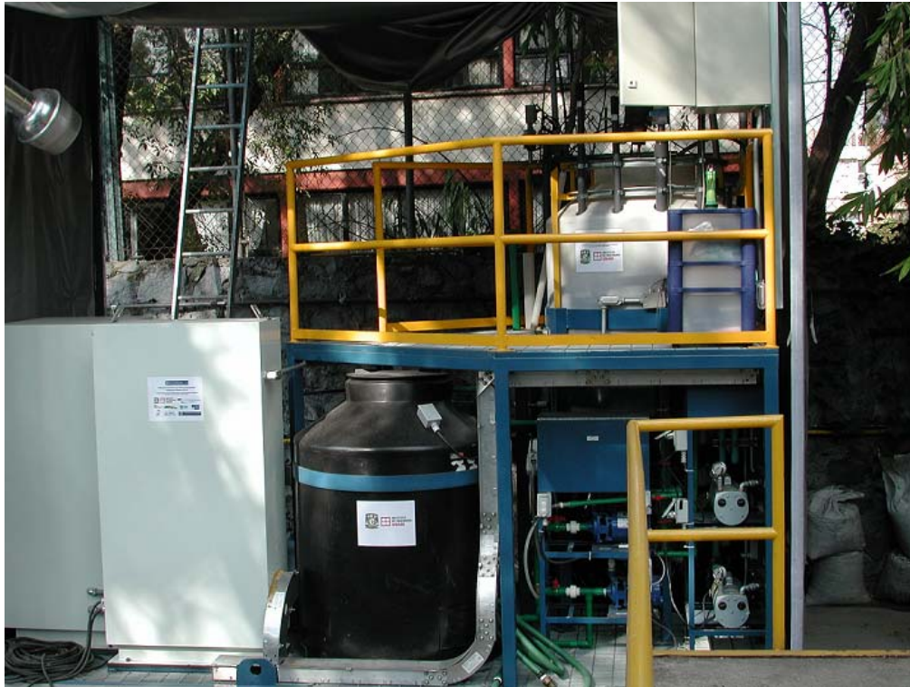
Fig. 3.5 Vista posterior de la planta piloto (equipo de bombas y sopladores)
