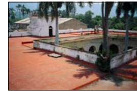
DETALLE DE DAÑO 2
