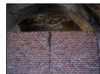
DETALLE DE DAÑO 10
