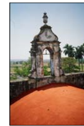
DETALLE DE DAÑO 6
