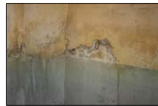
DETALLE DE DAÑO 3
