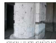
DETALLE DE DAÑO 12
