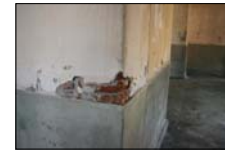
DETALLE DE DAÑO 2
