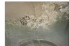
DETALLE DE DAÑO 4
