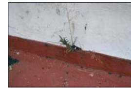
DETALLE DE DAÑO 1
