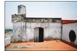
DETALLE DE DAÑO 3
