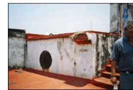
DETALLE DE DAÑO 4
