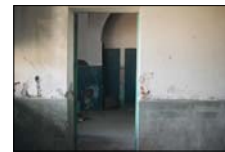
DETALLE DE DAÑO 1
