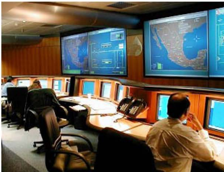
Fig. 14 Vista del Cuarto de Control Principal 7º piso de la Torre de PEMEX
