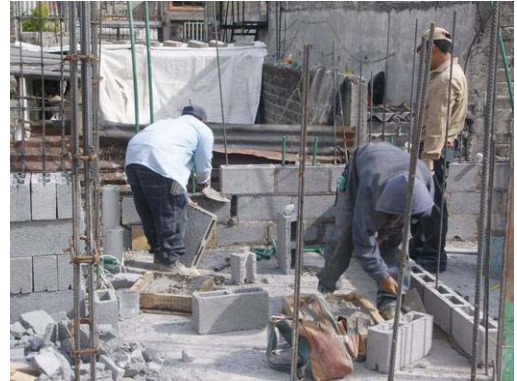
Construcción de muros de block gris, utilizado para los muros de colindancia e interiores. Se pueden apreciar las varillas que sirven para los castillos ahogados.
