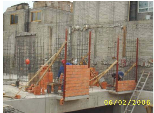
Construcción de muros de block rojo, utilizado para las fachadas. Aquí se pueden apreciar las reglas que los maestros utilizan para alinear y plomear correctamente los muros.
