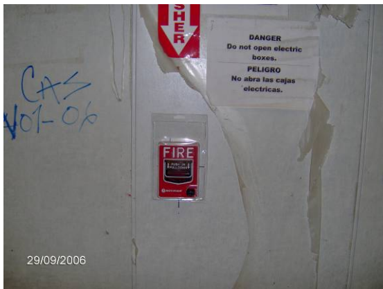
Interconexión de alarmas para fuego interior en 3º nivel.
