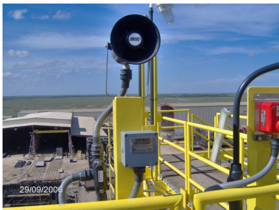
Interconexión de alarmas audibles exterior en la azotea
