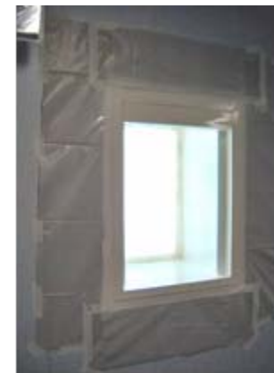
Aplicación de pintura a los marcos de las ventanas en 3º nivel.
