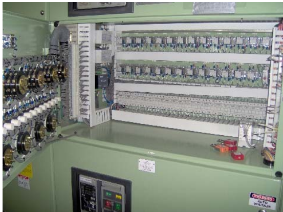
Cierre de pendientes del subsistema 903.01 (TD-5900)
