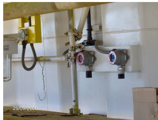
Interconexión de los detectores de gas en 2º nivel.
