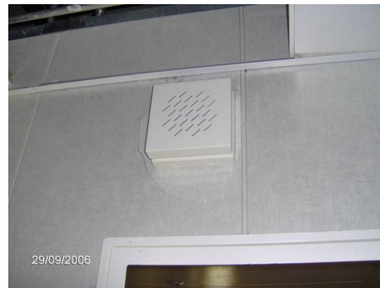
Interconexión de alarmas audibles interior en 4º nivel.
