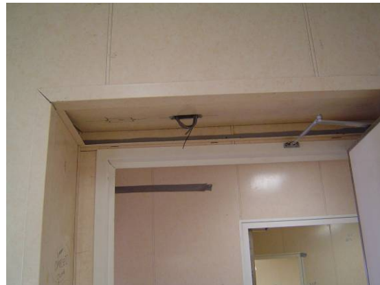
Alambrado del control de acceso de las puertas del cuarto de telecom en 5º. Nivel.
