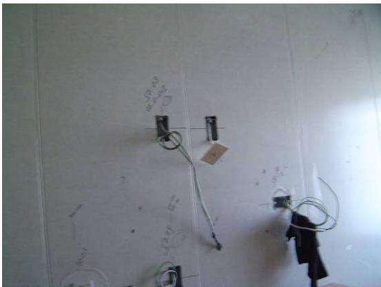
Alambrado de las salidas del sistema de entretenimiento en 5º. Nivel.
