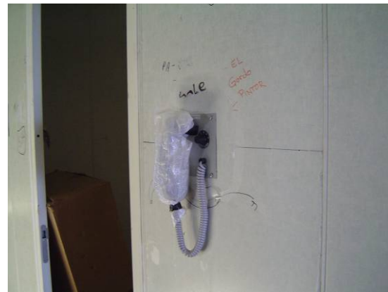
Instalación de estación sobre la pared del sistema de intercomunicación y voceo
