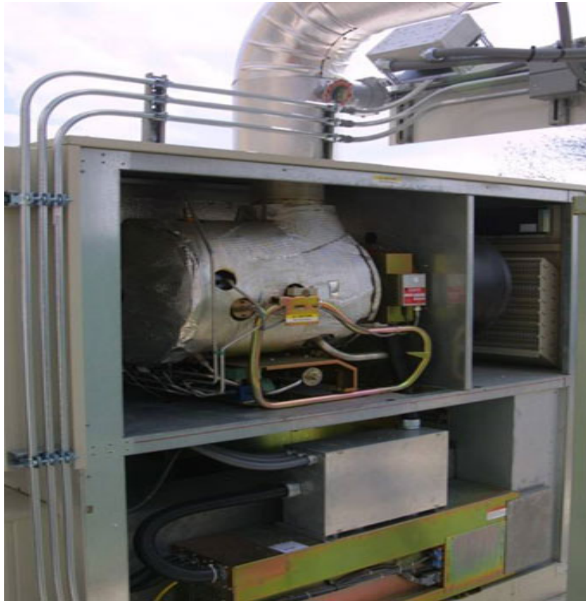
6.- Micro-turbina de 2 KiloWatts/Hora.
