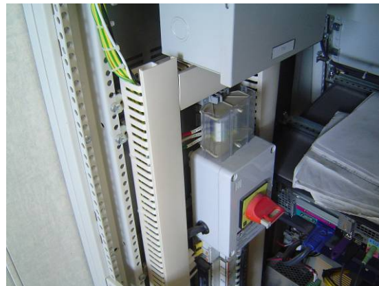
Alambrado del gabinete de control de acceso
