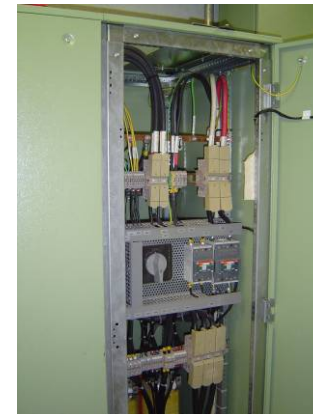
Cierre de pendientes del subsistema 907.05 (UPS-5923) telecom
