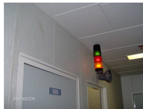
Interconexión de luces del sistema FM-200 en 5º. nivel.
