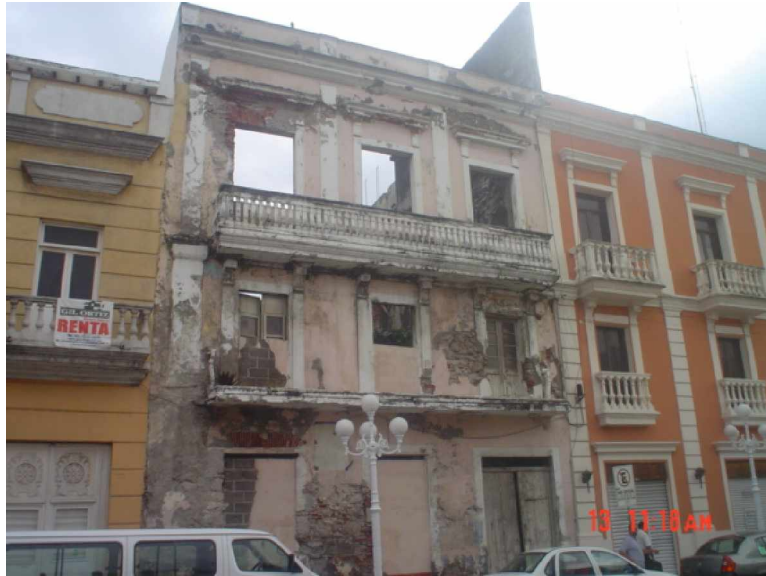
IMAGEN 7.- CALLE 5 DE MAYO CASO 2: PÉRDIDA DE ESTRUCTURA INTERIOR
