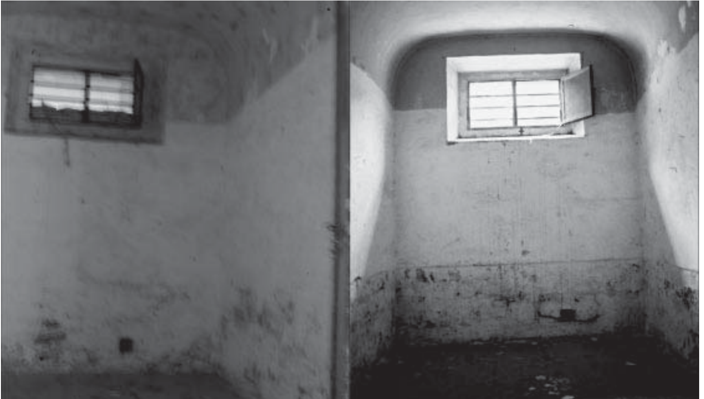
11. (arriba) Actual situación de las celdas, en completo deterioro.
