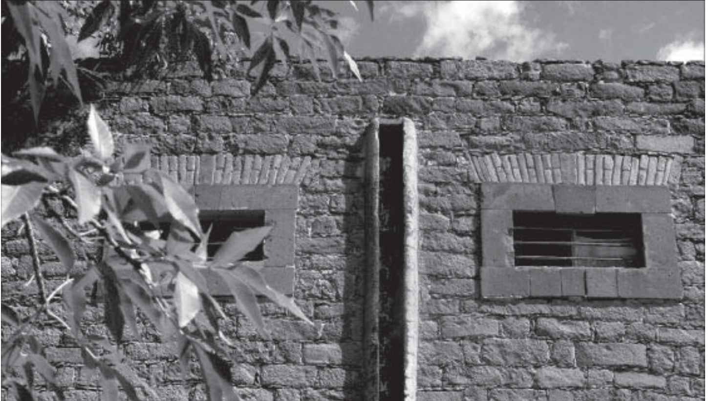
12. (abajo) Vista exterior de la fachada que presentan las crujiñas tipo, con sus bajadas de agua pluvial a restaurar.
