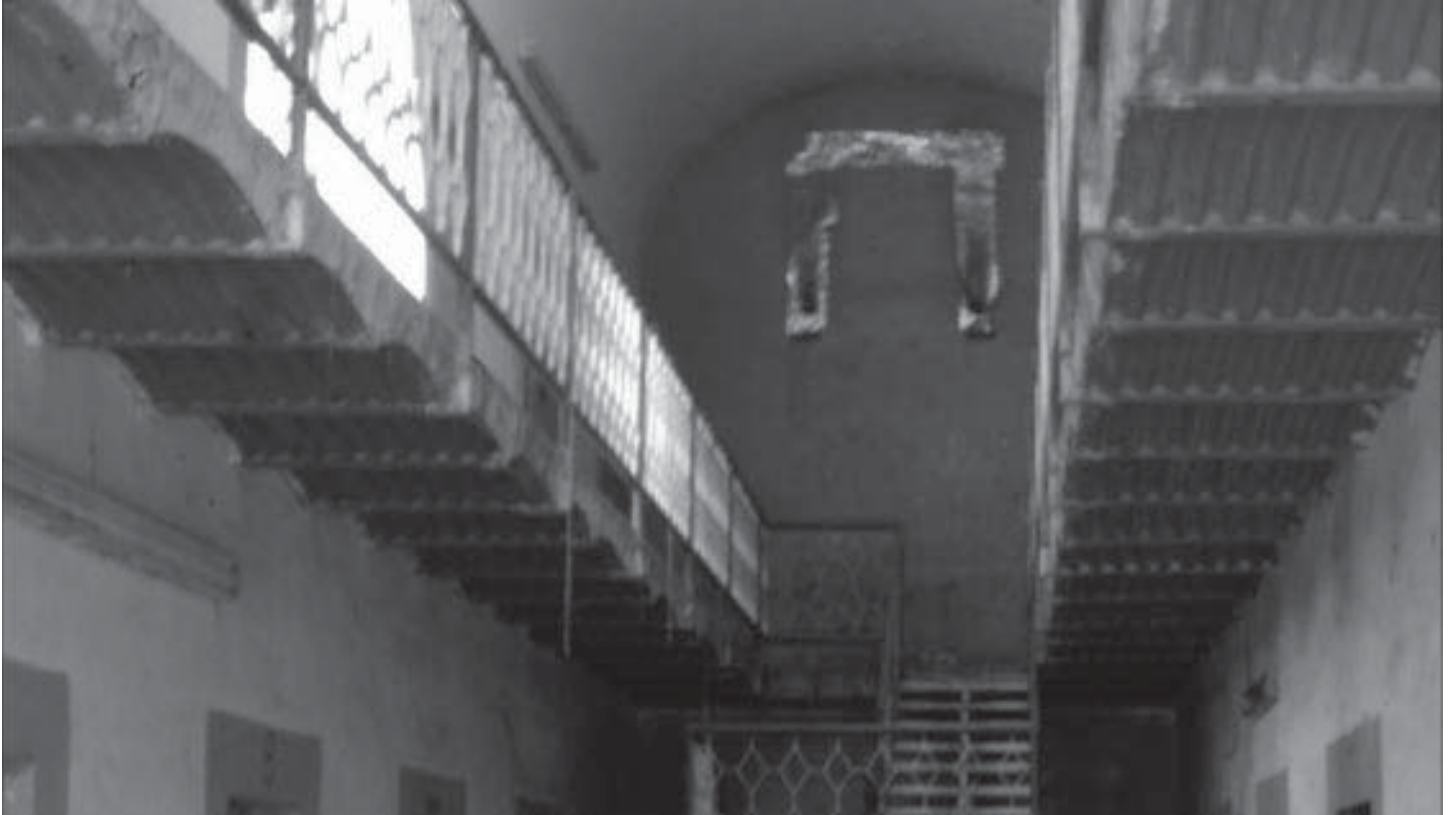
9. (arriba) Crujía tipo mostrando el estado de deterioro de los muros y los barandales del nivel superior.
