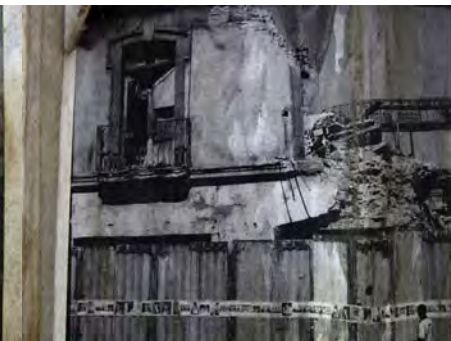
Fotografía-Fachada derruida-Casa Requena
