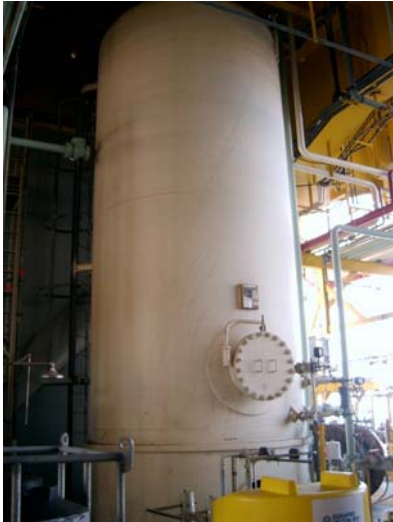
Fig.2.41 Tanque de aire de instrumentos.
