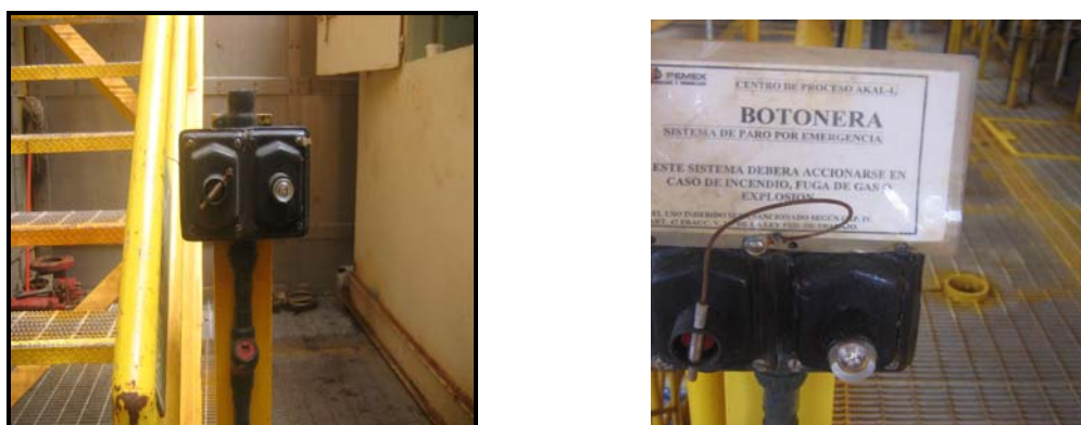
Fig. 6.1 Botoneras de escaleras.
