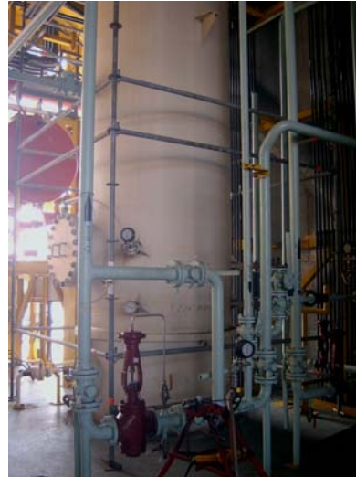
Fig.2.42 Tanque de aire de planta.
