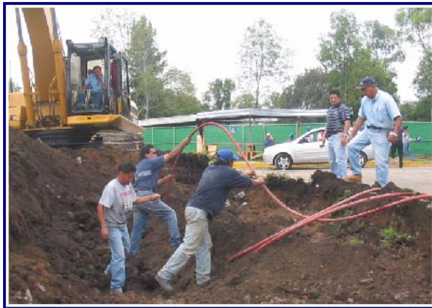
En esta fotografía se puede observar el manejo para la reubicación de la línea de fibra óptica en la zona sur del proyecto
