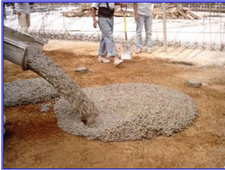
Aquí se puede ver la técnica que se utiliza para extender el concreto.
